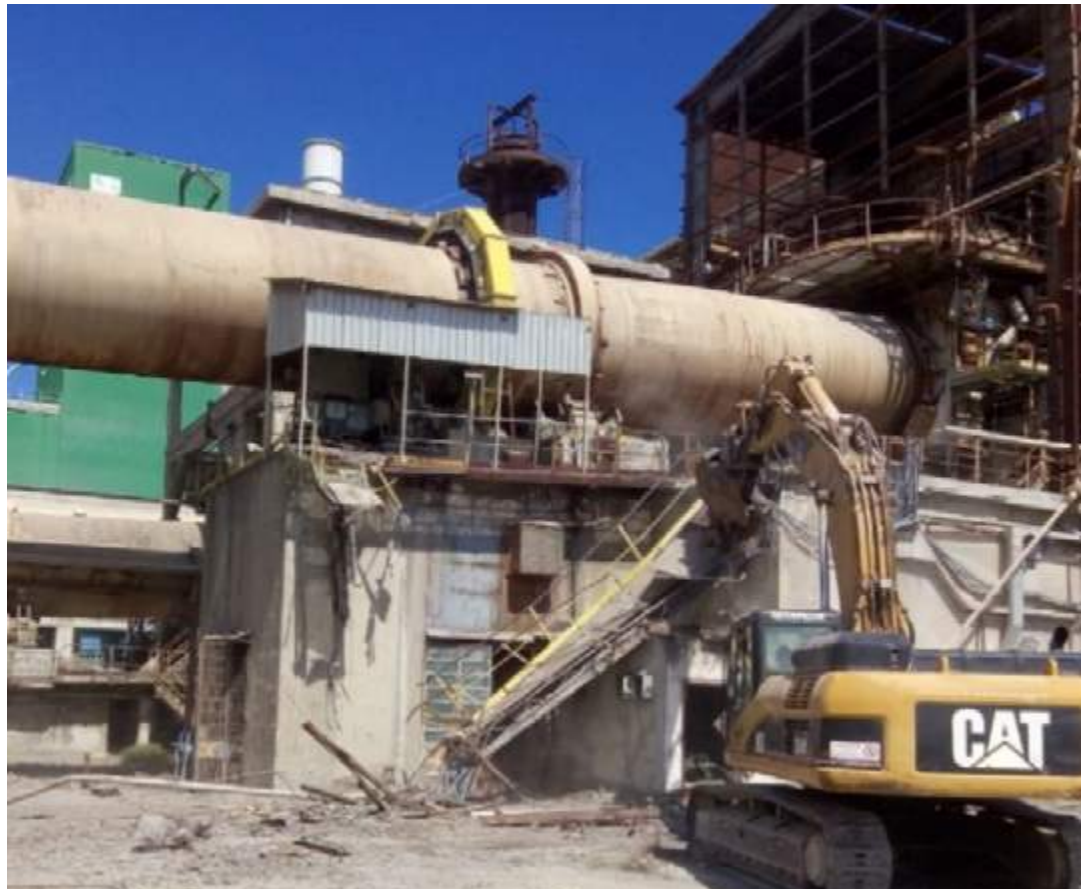
Escavatori cingolati CAT330 muniti di pinze idrauliche utilizzati per le demolizioni. CAT330 crawler excavators equipped with hydraulic pliers used for demolitions.
